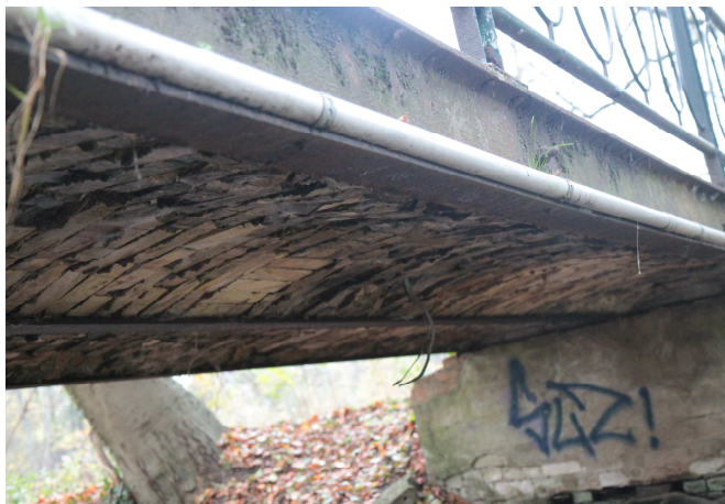
Marode Schlossparkbrücke - oben hui, unten pfui!
